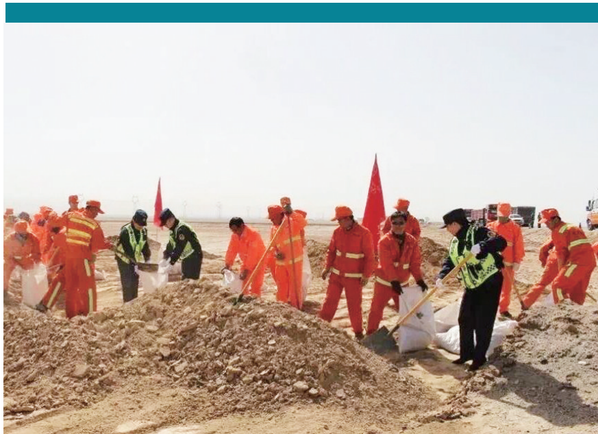
由于近期连降暴雨,影响车辆安全行驶,海西州茫崖路政大队茫崖公路段于近日联合开展了公路水毁应急抢险与公路交通安全事故应急救援演练活动,以实战演练提高应对突发事件快速反应和应急处置能力。
