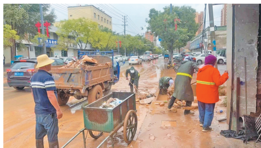
8月31日，海东市循化撒拉族自治县受强降雨影响，导致城区内部分路段大面积积水，严重影响市民出行安全。为尽快恢复城区道路环境，当日，循化县城市管理综合行政执法局立即启动应急预案，明确责任分工，组织人员排查洪涝点并及时开展雨后道路清洁工作。图为清理现场。 本报记者 李永兰 摄
